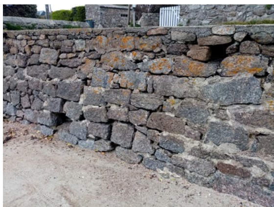
L'entretien régulier des joints permet d'assurer la protection de la côte Photo : Louisa Le Rouzic
