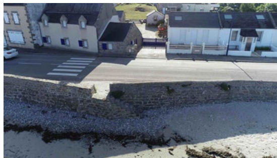
Système d'endiguement possible à Melon (Porspoder), il faudrait alors fermer les accès avec des batardeaux. Photo : Casagec Ingénierie.
